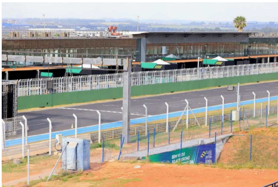
Troca completa da capa asfáltica do Autódromo Internacional de Goiânia Ayrton Senna será executada pela empresa responsável
