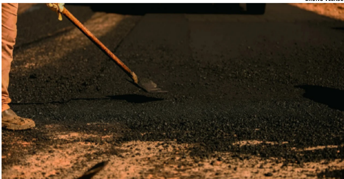
Sistema faria mapeamento e avaliação do piso asfáltico de todo município para otimizar reparos
