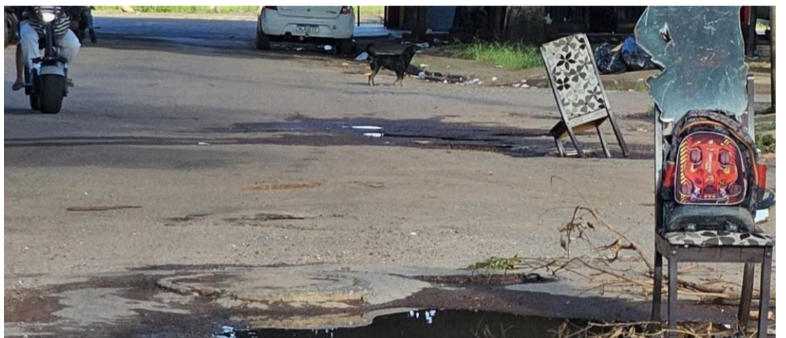
Região no setor Centro-Oeste: moradores pedem interdição de vias por causa de 'crateras'
