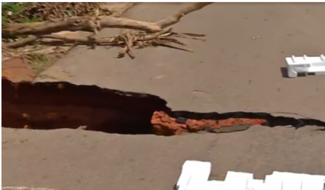
A ponte que caiu em área urbana fica na Rua Anhanguera, via que conecta a Avenida Brasil ao bairro Vila Goiás
