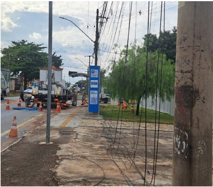
Presença de fios de energia soltos nas ruas é um retrato da negligência com a segurança da população
